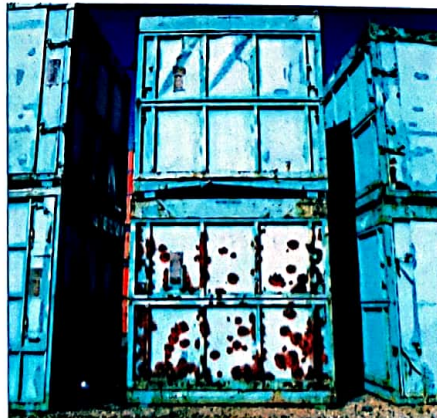
Efecto de la corrosión.
